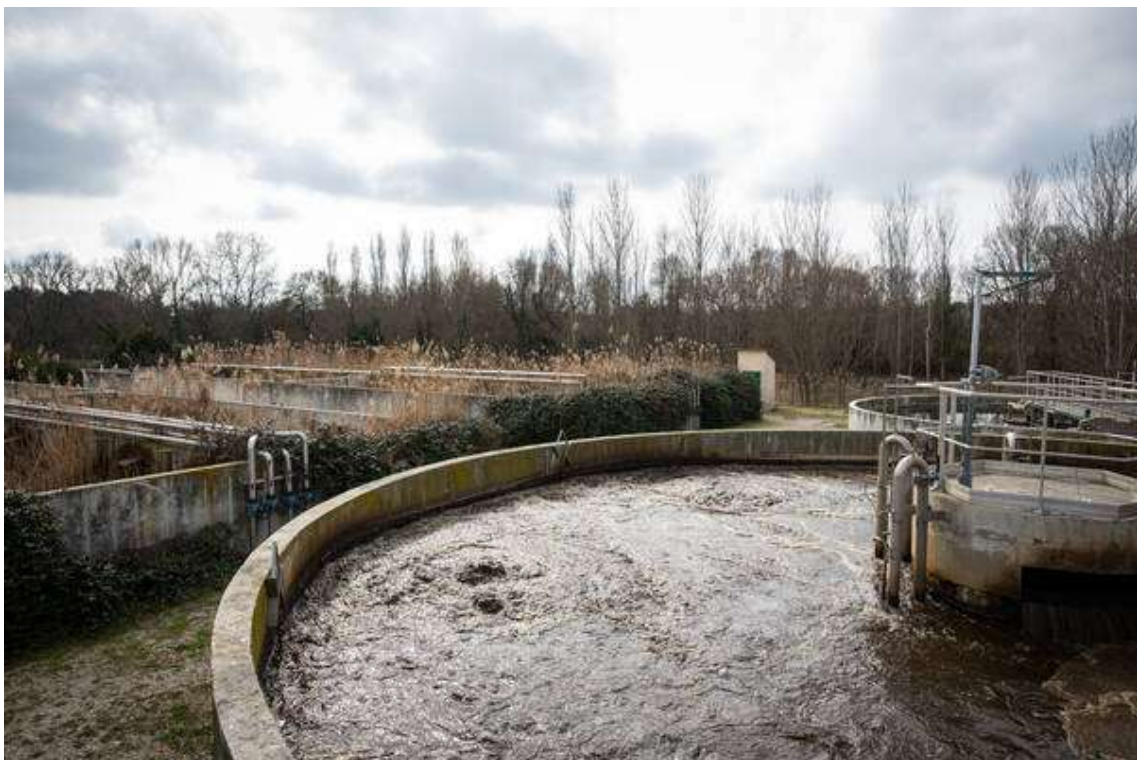
Les bassins de filtrations sont plantés de roseaux. Au premier plan, un bassin de boues activées. (David Richard/Transit pour Libération)
